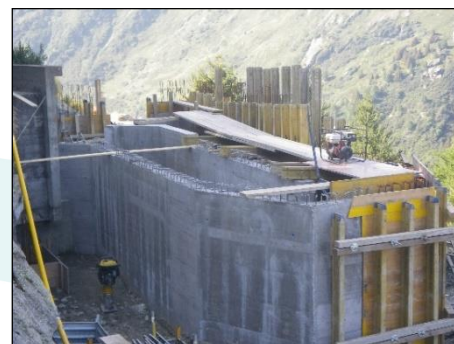
Chambre de turbinage
