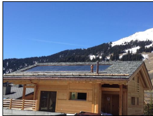
Installation solaire PV à Verbier
