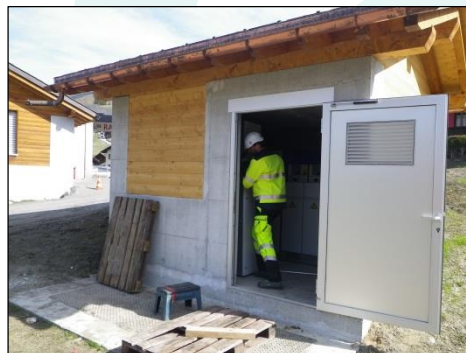
Poste de couplage MT Le Château
