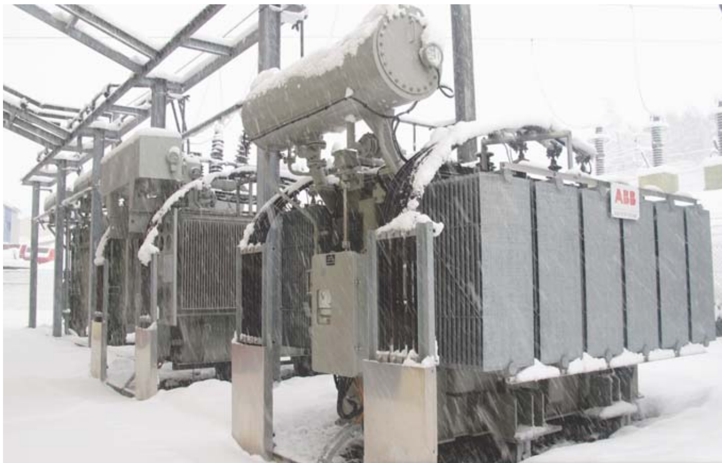
Ces deux transformateurs 10/20 kV font partie des installations vendues par le FMO à la nouvelle société DransGrid. LE NOUVELLISTE
